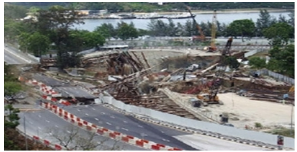
Hình 6. Sập hầm đường tàu điện ngầm (MRT) tại Singapore, năm 2004
